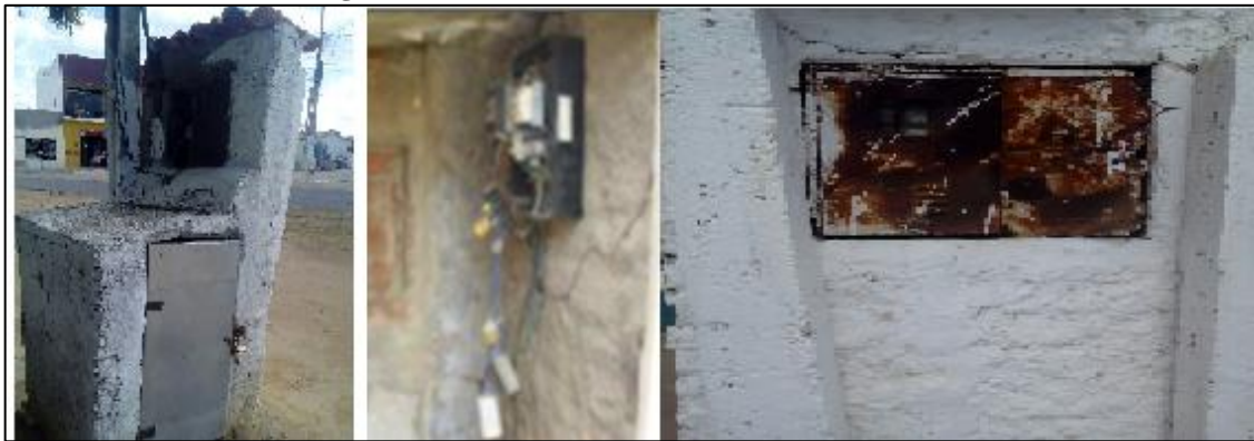
Figura 3.17 - Quadro de comando elétrico da bomba.
