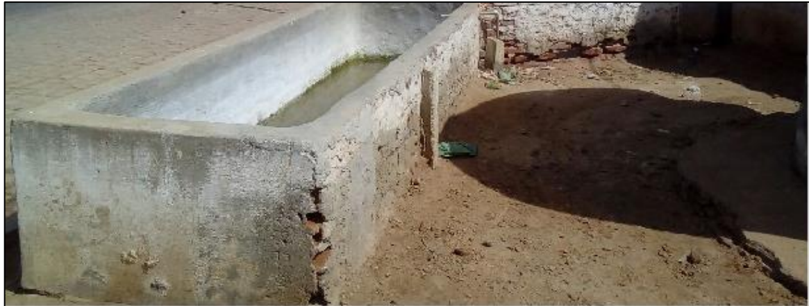
Figura 3.18 - Fissuras externas no Tanque de distribuição.
