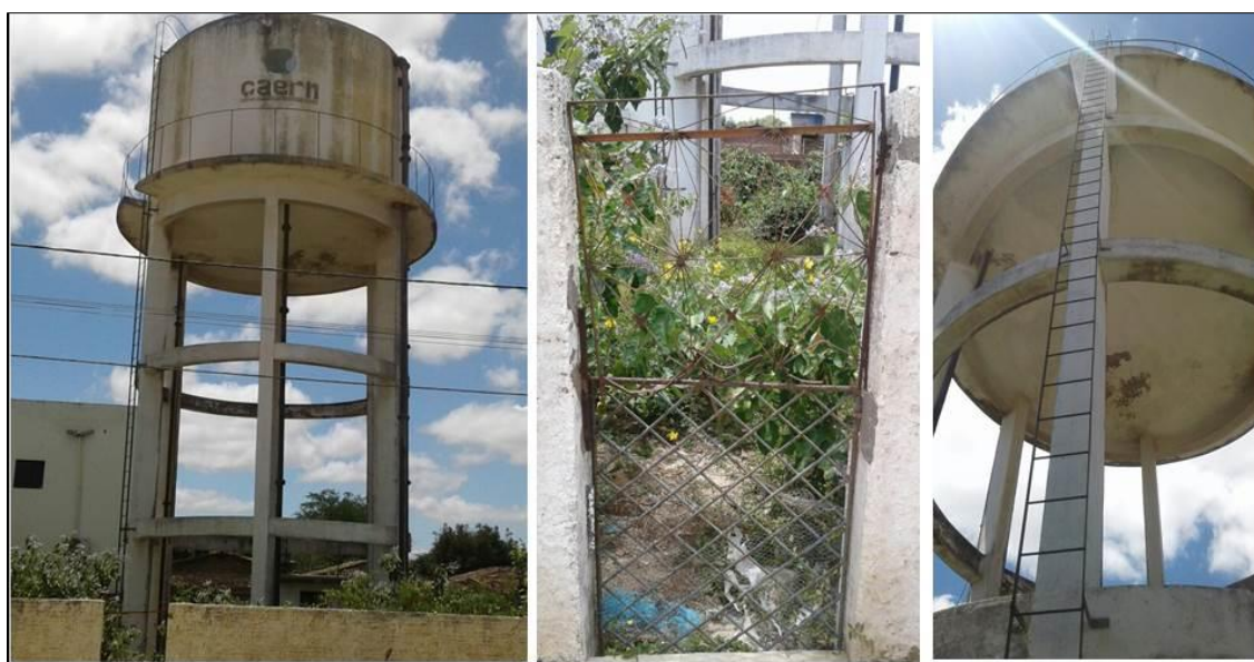
Figura 3.12 Acesso ao reservatório e a seus componentes.
