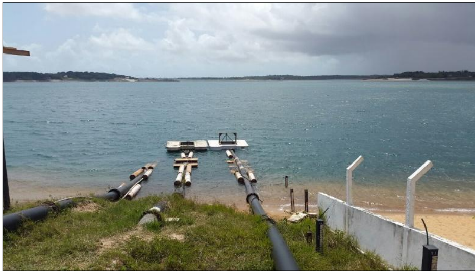
Figura 3.7 - Captação na Lagoa do Bonfim
