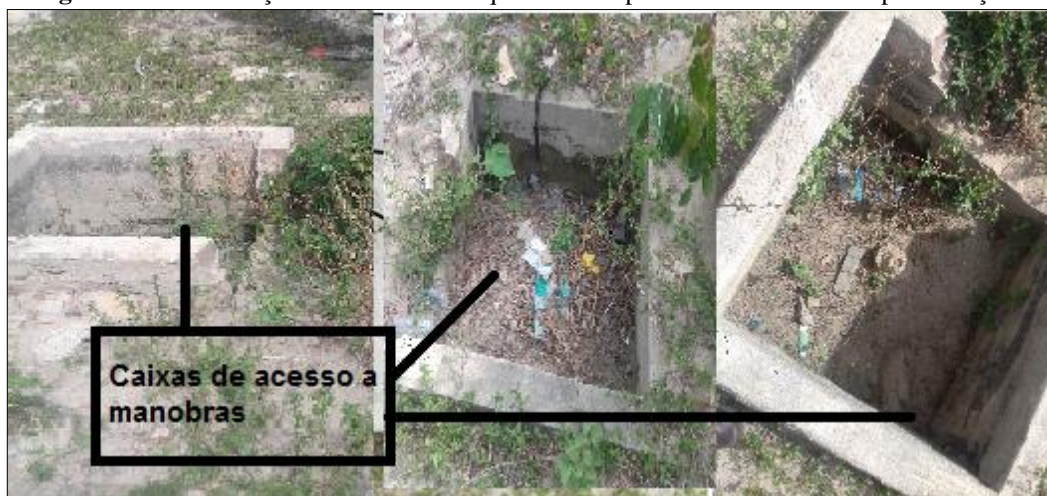
Figura 3.11 - Infiltrações no reservatório que abastece parte da sede do Município de Jaçanã.
